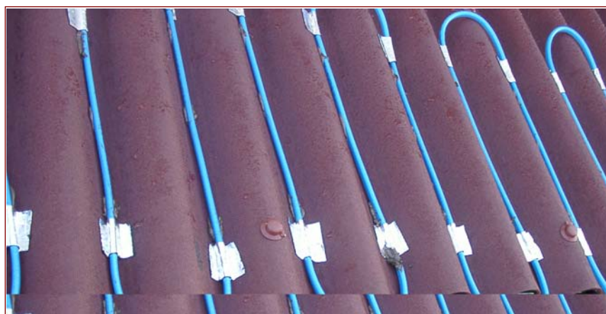
Rys. 2 Przewód grzewczy na połaci dachowej (foto Firmy ELEKTRA)
